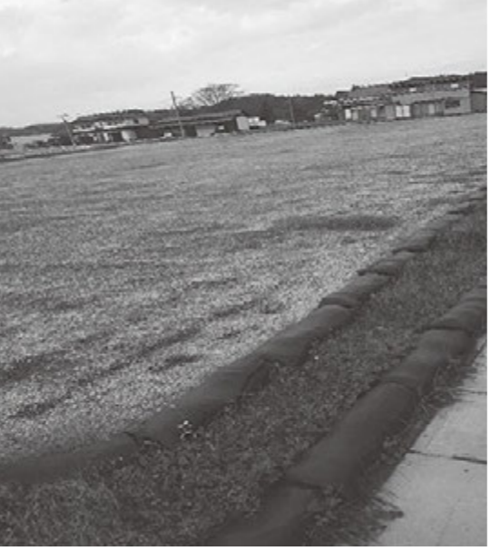
▲防災コミュニティセンター建設予定地と掘削作業中の吉田川河川敷
