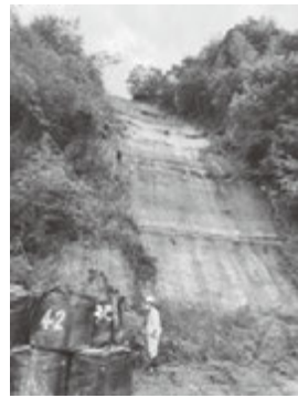
▲木ノ崎地区急傾斜地崩壊現場
