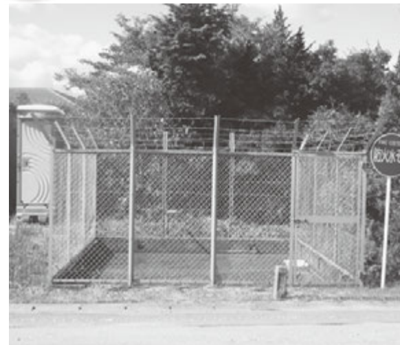
▲防火水槽から消火栓へ切り替わることになった(中村)
