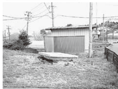
▲地震により盛り上がった浄化槽(山崎分館)
