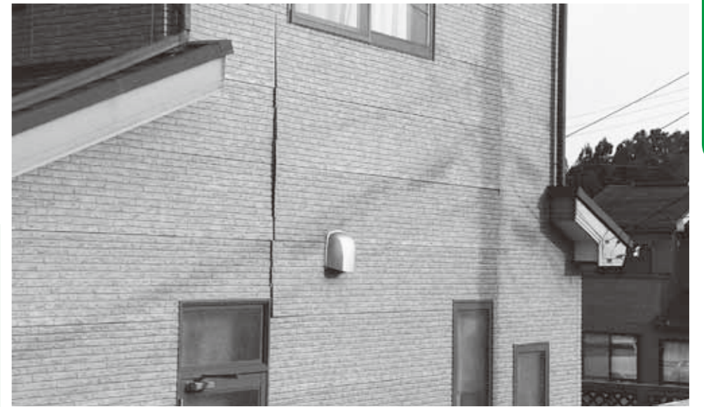
▲希望の丘団地住宅の傷んだ外壁
