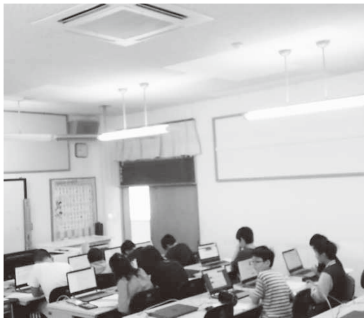
▲エアコンが設置されている特別教室
