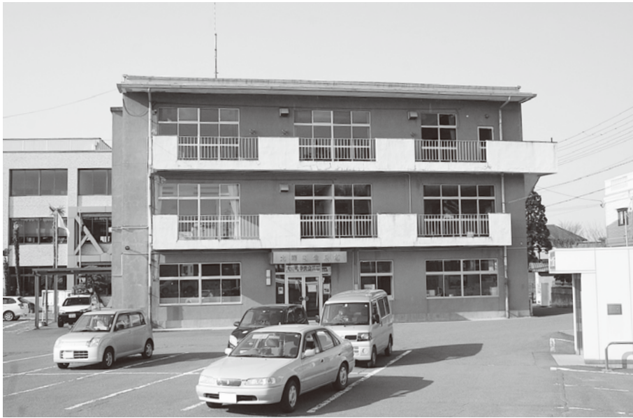
▲中央公民館も劣化が進んでいる
