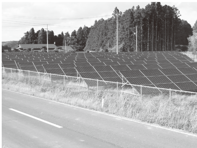
▲反射光被害防止にも行政の設置チェックが急がれる
