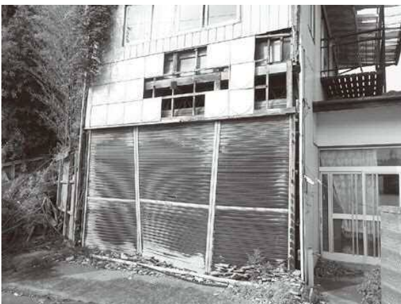
▲急がれる空き家対策
