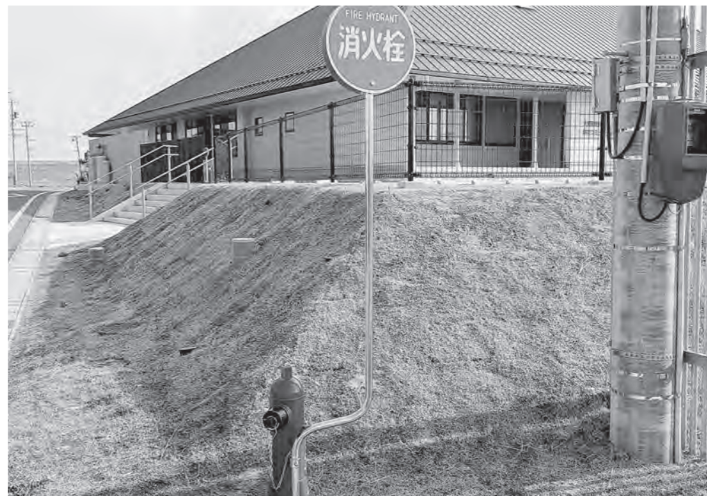
▲新設された消火栓
