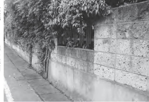
▶危険ブロック塀の解消を
