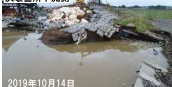
決壊箇所下流側
