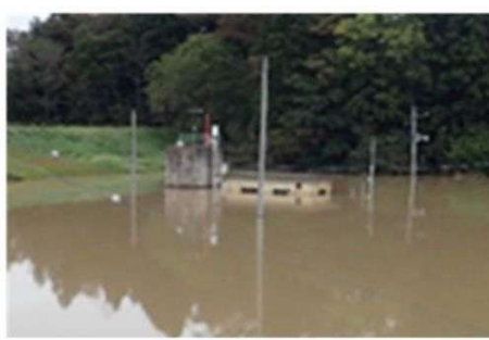
令和元年東日本台風 後谷地排水機場浸水
